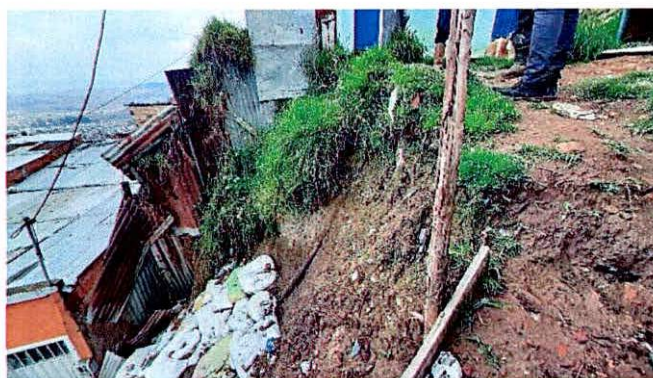
Fotografía 2. Movimiento en masa que afecta la vía el poste localizado frente a la vivienda de la KR 4A Bis Este No. 59B - 15 Sur
