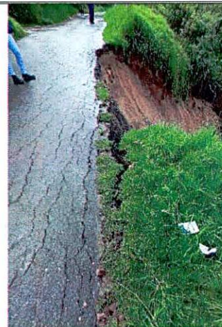
Fotografía 10. Patologías de pavimento y socavación del suelo de soporte
