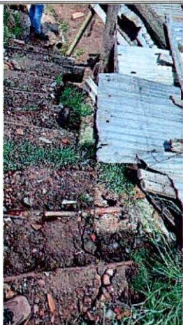
Fotografía 3. Grietas de tracción en las escaleras perimetrales a la vivienda evaluada
