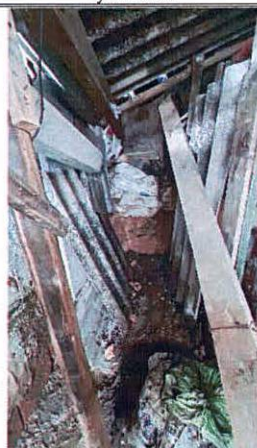
Fotografía 4. Movimiento en masa local, depósito de material y contención con elementos de madera
