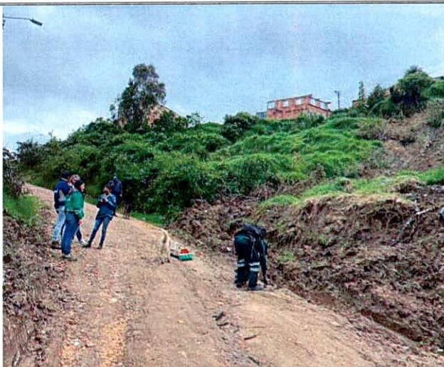
Fotografía 15. Vía de la Calle 61 Sur entre carrera 4 y 5 Este, despejada; se evidencian filtraciones fluyendo sobre la vía y talud. Foto tomada 15 mayo 2024
