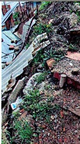
Fotografía 4. Movimiento en masa que afectó la zona de cocina de la vivienda evaluada
