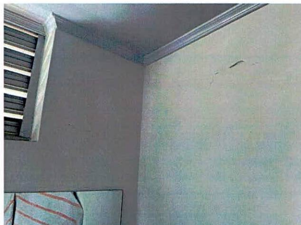
Fotografía 16. Fisuras en muros perimetrales y divisorios en apartamento 218 interior 9 predio evaluado.
