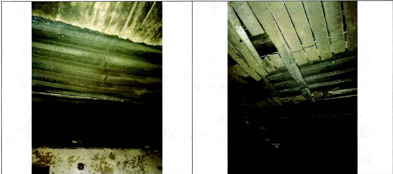
Fotografía 4. Daños en el cielo raso del apartamento donde ocurrió el incendio.
