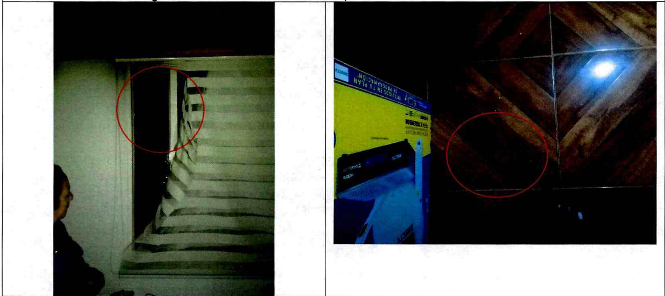
Fotografía 6. Daños en ventanearía y en las baldosas del apartamento en el apartamento 401.
