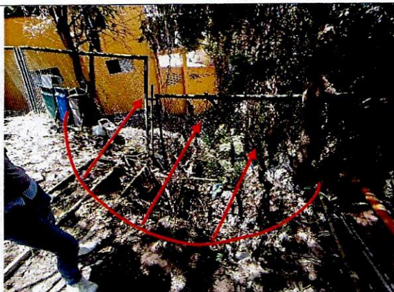
Fotografía 12. Vista superior del desprendimiento de suelo en costado occidental de la huerta. Tomada el 26/01/2024
