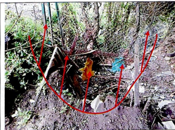
Fotografía 11. Vista superior del desprendimiento de suelo en costado occidental de la huerta. Tomada del DI-19601 (04/10/2023)
