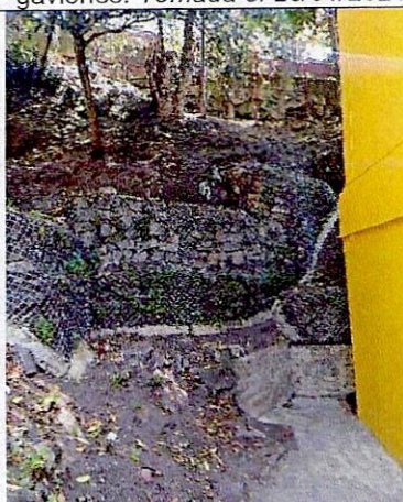
Fotografía 4. Muestra del estado de gaviones en acceso a huerta. Tomada el 26/01/2024
