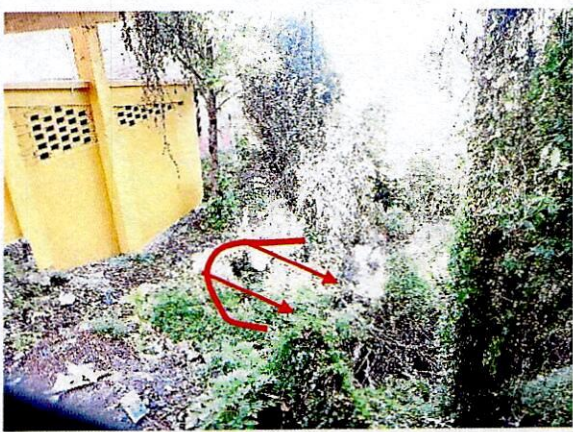
Fotografía 15. Socavación en margen izquierda de Q. Soratama. Tomada del DI-19601 (04/10/2023)
