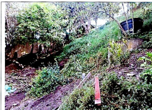
Fotografía 5. Muestra de supuestas obras de estabilización en costado oriental de la huerta. Tomada del DI-19601 (04/10/2023)
