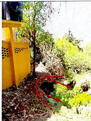
Fotografía 16. Socavación en margen izquierda de Q. Soratama. Tomada el 26/01/2024
