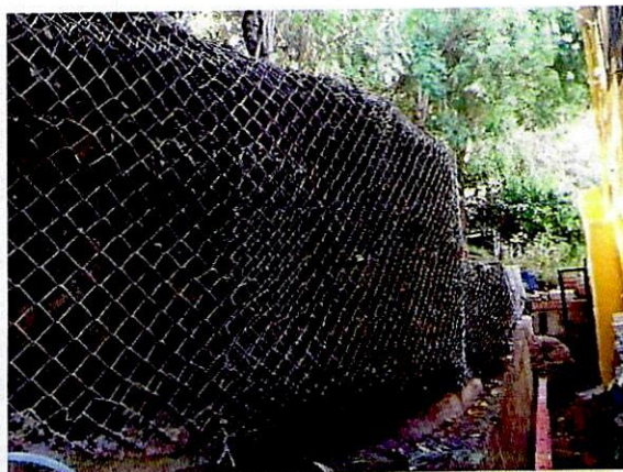
Fotografía 1. Muestra de mantenimiento en gaviones. Tomada del DI-19601 (04/10/2023)
