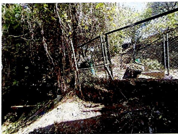
Fotografía 13. Vista frontal de pérdida de verticalidad del cerramiento occidental de huerta. Tomada el 26/01/2024
