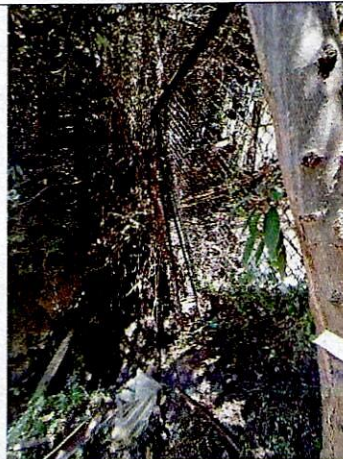
Fotografía 13. Vista de perfil de pérdida de verticalidad del cerramiento occidental de huerta. Tomada el 26/01/2024
