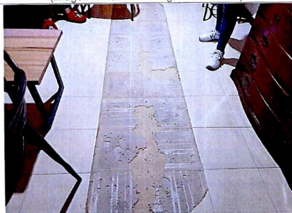
Fotografía 3. Apartamento del tercer nivel con levantamiento de baldosas, zona de comedor.
