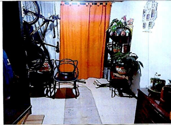
Fotografía 4. Zona de comedor con baldosas desinstaladas.
