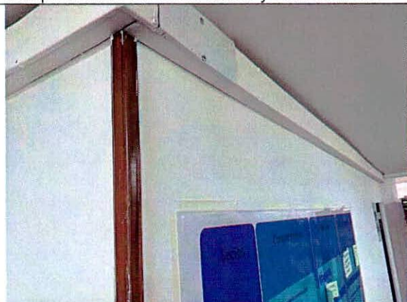
Fotografía 5. Muros internos de la oficina 901 con presencia de humedades y fisuras leves.
