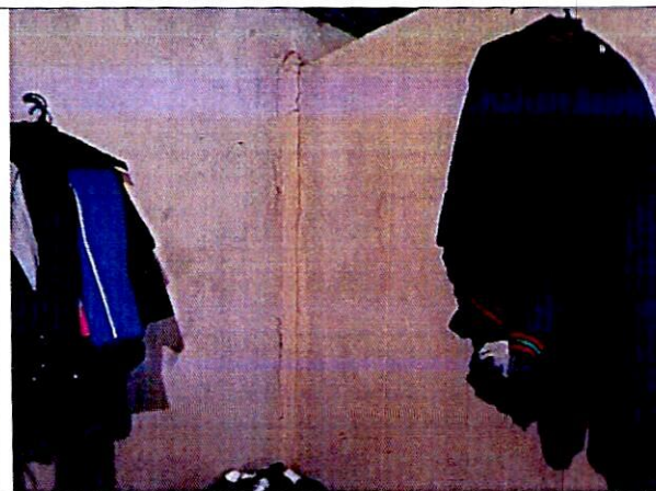
Fotografía 8. Fisura entre muros de las habitaciones del costado occidental.
