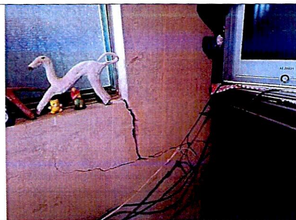
Fotografía 7. Grieta en muro divisorio de una de las habitaciones del costado occidental.
