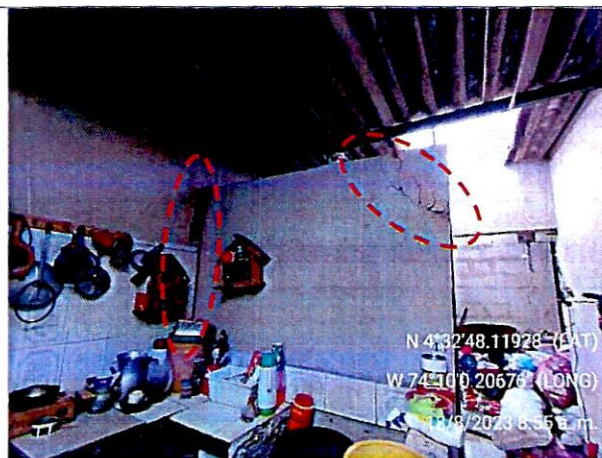
Fotografía 3. Dilatación en la unión entre muros y grieta de tendencia diagonal e muro de cocina y baño.
