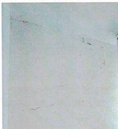
Fotografía 5. Vista general de la grieta en muro de segundo nivel de la casa 87
