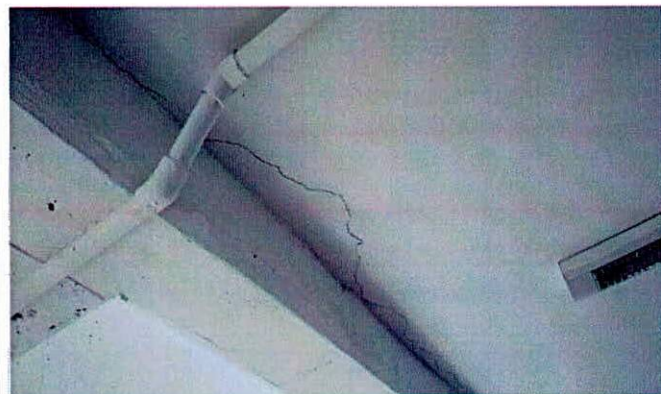
Fotografía 4. Vista general de la grieta en la placa de sótano.
