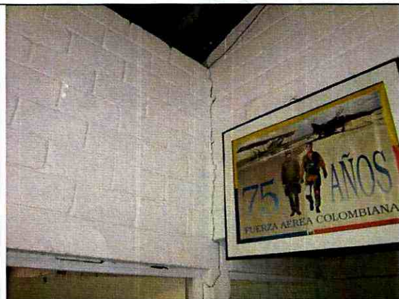
Foto 9. Grieta por separación de junta entre muros.
