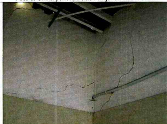
Foto 11. Grietas en muros del costado sur.
