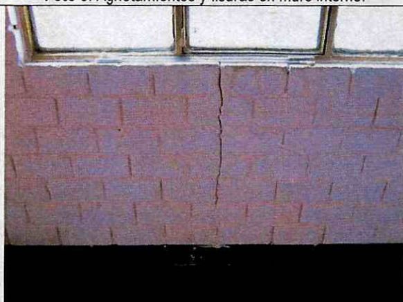
Foto 7. Agrietamiento vertical en muro oriental.
