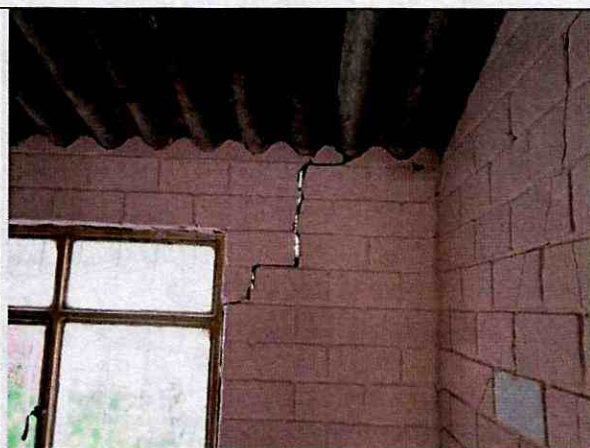
Foto 4. Fractura superior del muro del costado oriental.
