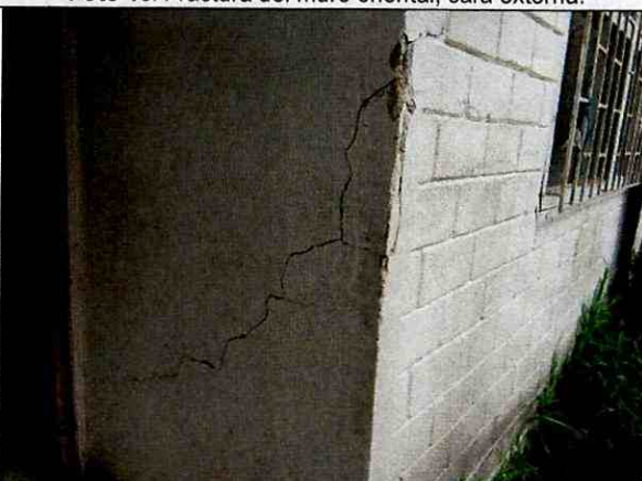
Foto 20. Fisuras y grietas en muros externos, sector patio.
