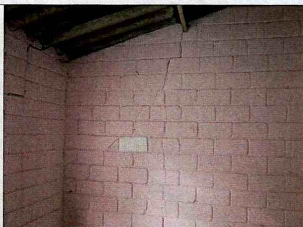
Foto 6. Agrietamiento diagonal en muro interno.
