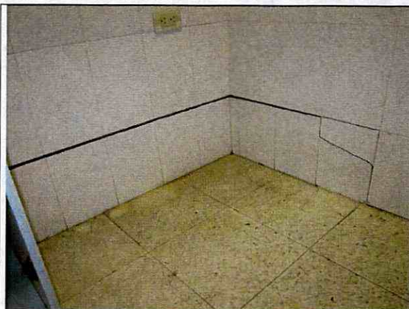
Foto 15. Grieta horizontal en muro del costado sur.
