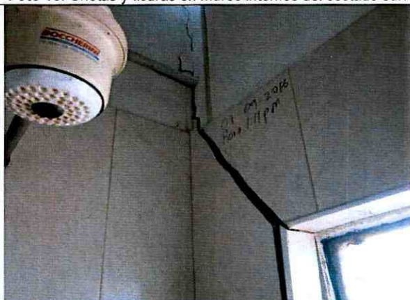
Foto 12. Fractura del muro de fachada, cara interna.
