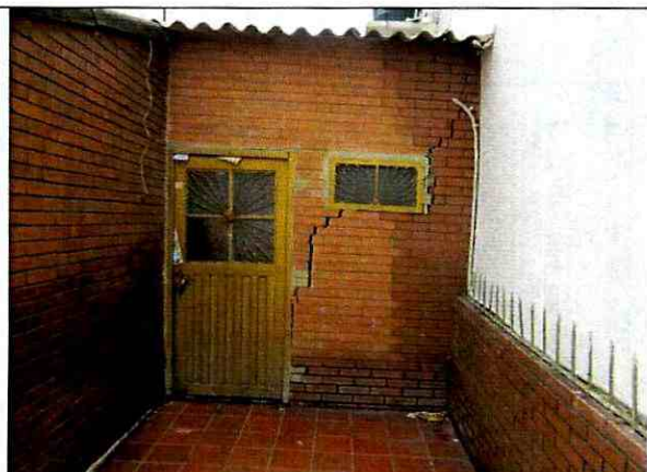
Foto 2. Muro de fachada con daño severo y deterioro fuerte.
