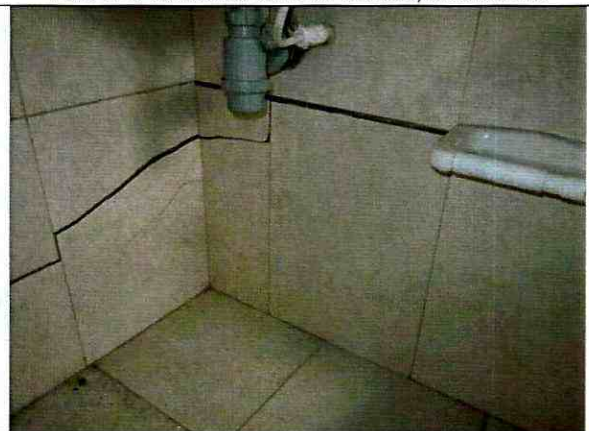
Foto 14. Grieta en muro del costado sur.
