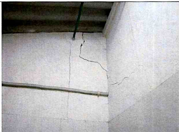
Foto 10. Grietas y fisuras en muros internos del costado sur.
