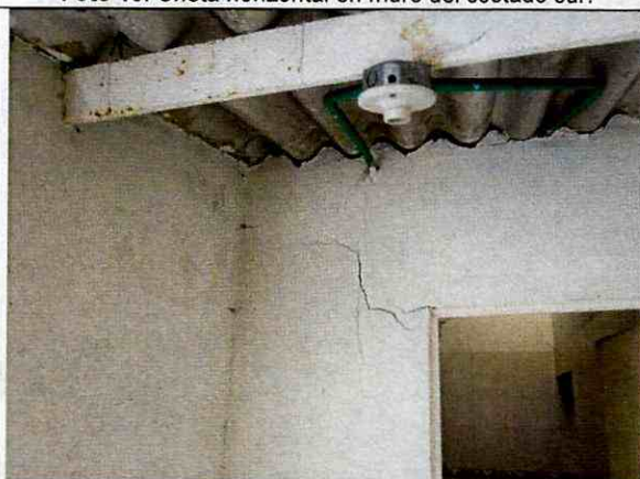
Foto 17. Grieta en sector del dintel de muro interno.
