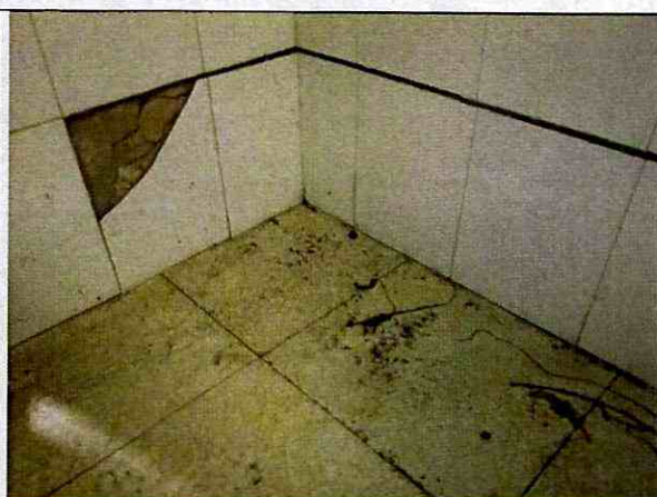
Foto 16. Grieta horizontal y daños de los acabados.
