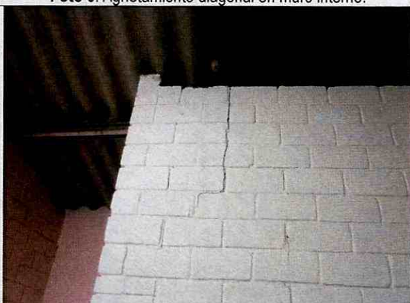
Foto 8. Grieta vertical en parte alta del muro.
