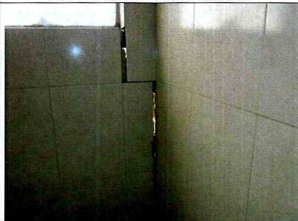
Foto 13. Fractura en extremo sur de la fachada, cara interna.
