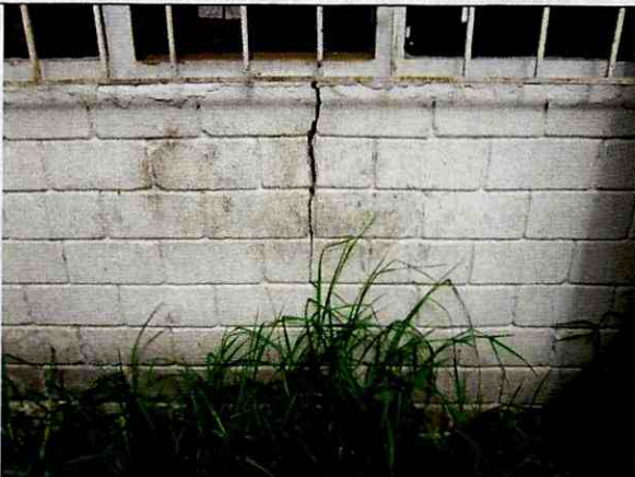
Foto 19. Vista externa de la grieta vertical del muro oriental.
