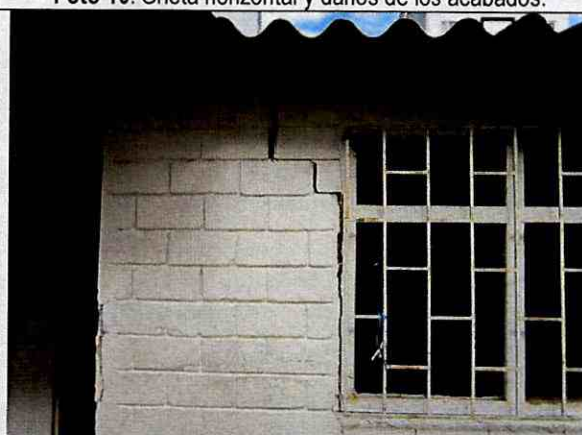
Foto 18. Fractura del muro oriental, cara externa.
