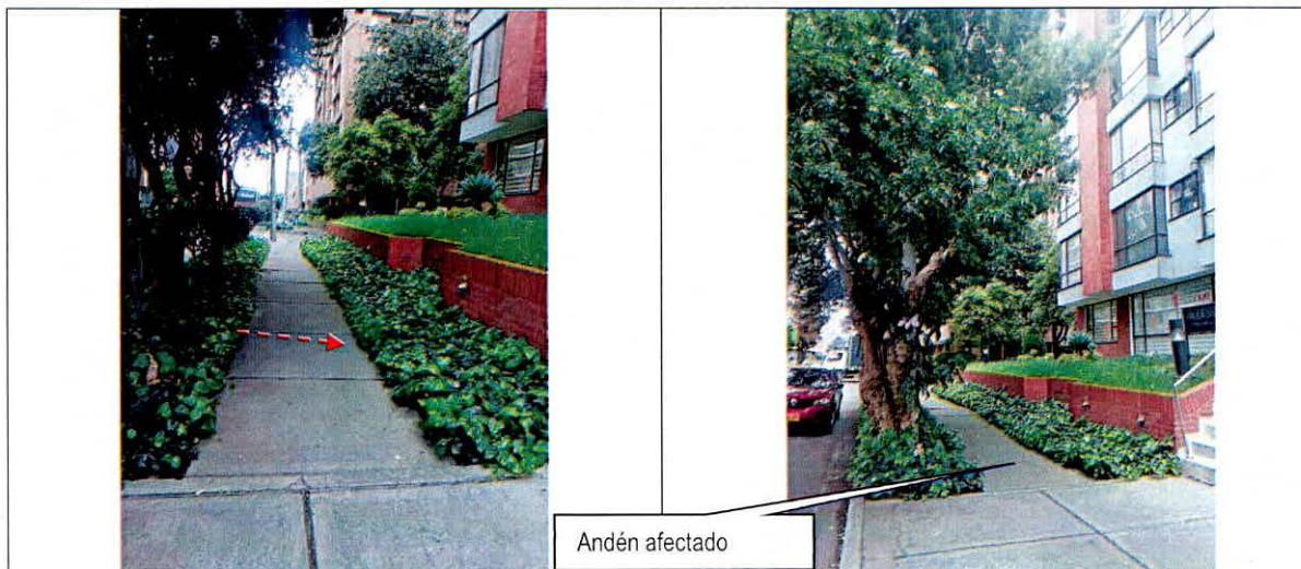
Fotografía 5. Deformaciones del andén aledaño al predio evaluado.
