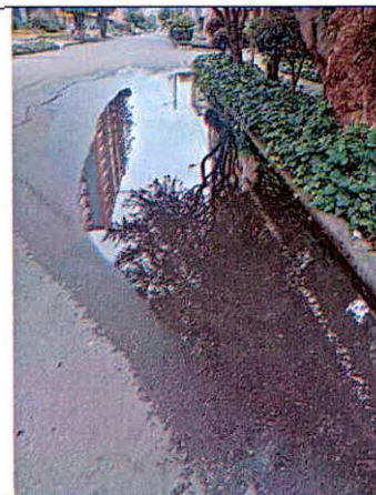
Fotografía 4. Empozamiento de agua en la vía de la CL 145A frente al Edificio Paula Jimena.
