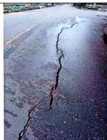
Fotografía 3. Agrietamientos de la capa asfáltica de la CL145A carril oriental.
