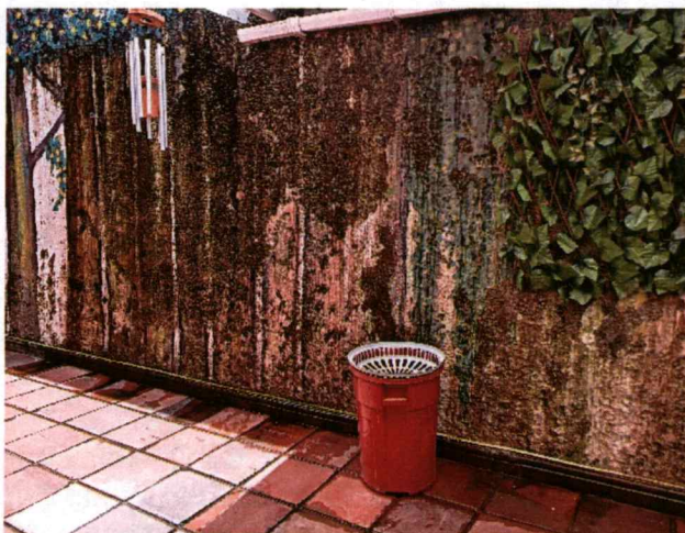
Fotografía 12. Manchas de humedad muro perimetral costado oriental apartamento 101 predio evaluado.
