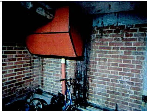
Fotografía 6. Filtraciones y huellas de humedad en muros del sótano de parqueaderos..
