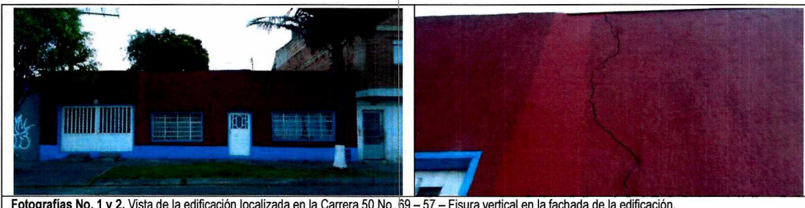
Fotografías No. 1 y 2. Vista de la edificación localizada en la Carrera 50 No. 69 – 57 – Fisura vertical en la fachada de la edificación.
