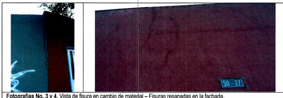
Fotografías No. 3 y 4. Vista de fisura en cambio de material – Fisuras resanadas en la fachada.
