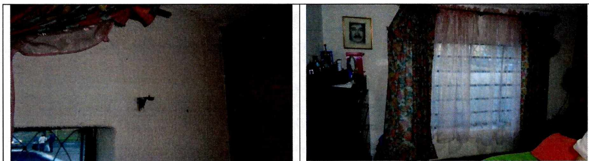
Fotografías No. 5 y 6. Vista del interior del muro de cerramiento que se encuentra afectado.
