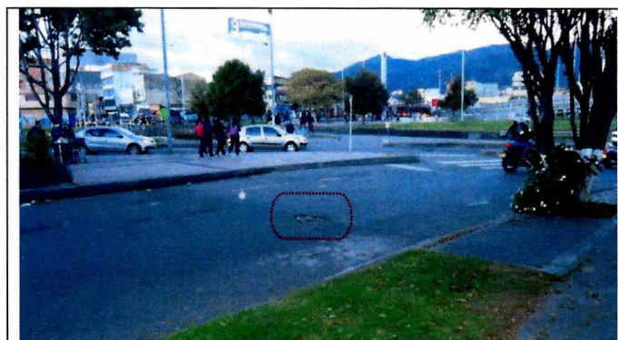
Fotografía 9. Estado de la Calle 70 frente al predio evaluado. Se resalta la rotura del pavimento asfáltico reportada por el peticionario.
