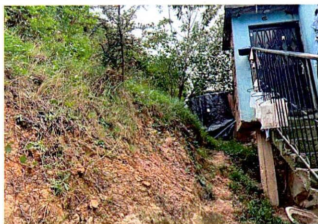
Fotografía 7. Material suelto del talud localizado al costado oriental de P2
