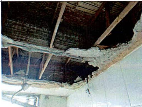
Fotografía 5. Daños en la placa de entepiso del cuarto de ropas del apartamento 902.
