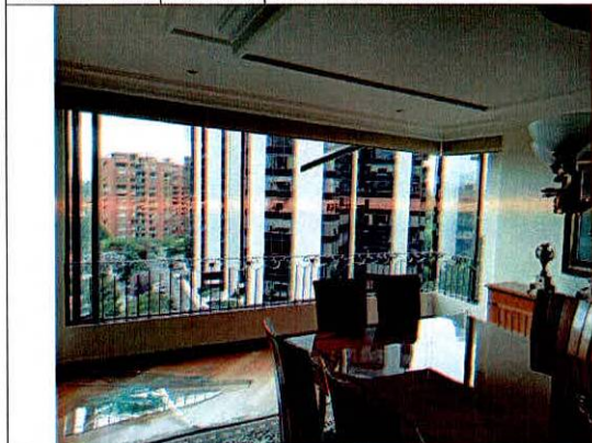
Fotografía 9. Ventanas afectadas al interior del apartamento 902 evaluado.
