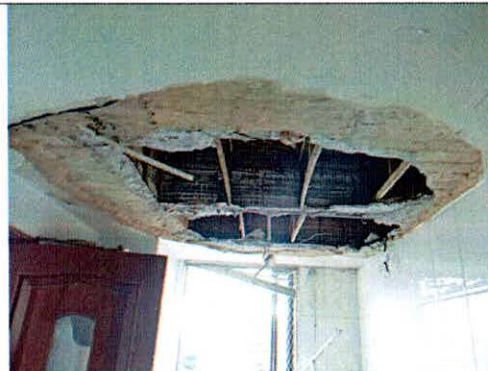
Fotografía 6. Daños en la placa de entepiso del cuarto de ropas del apartamento 902.
