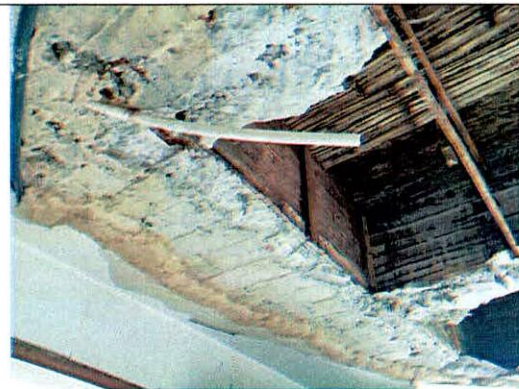
Fotografía 8. Daños en la placa de entrepiso del cuarto de ropas del apartamento 902.
