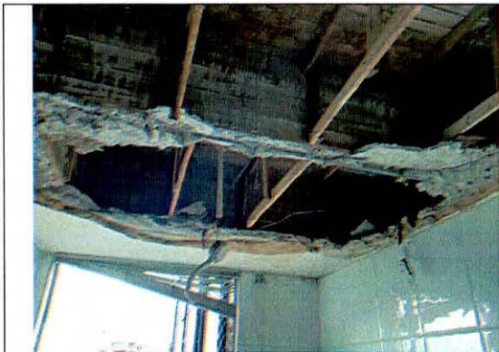
Fotografía 7. Daños en la placa de entrepiso del cuarto de ropas del apartamento 902.
