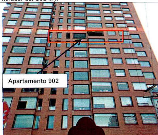
Fotografía 3. Vidrios de fachada afectados del apartamento 902 de la Torre Sur del edificio inspeccionado.
