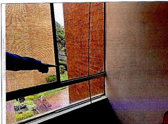
Fotografía 5. Rotura de vidrios en suroriente del piso 3 Int. 4. Tomado del DI-17244 (20/04/2022)
