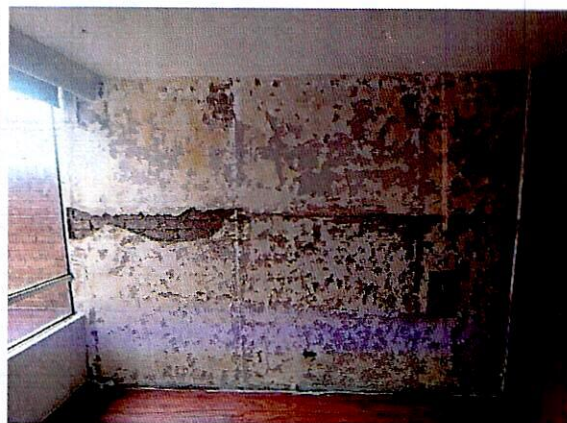
Fotografía 12. Condición actual de muro suroriental del piso 4 del Interior 4
