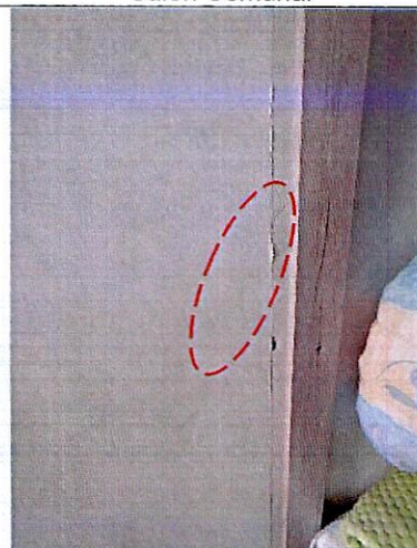
Fotografía 16. Muestra de fisuras en muro del Apartamento 101 – Interior 4
