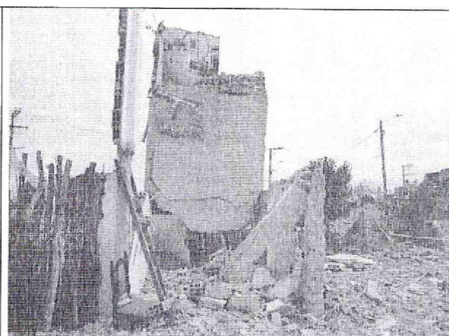
Foto 10. Pérdida de verticalidad de la edificación.
