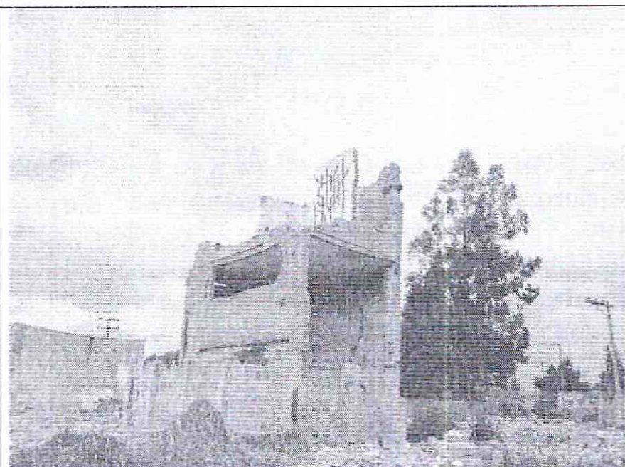
Foto 3. Inestabilidad general por demolición parcial.
