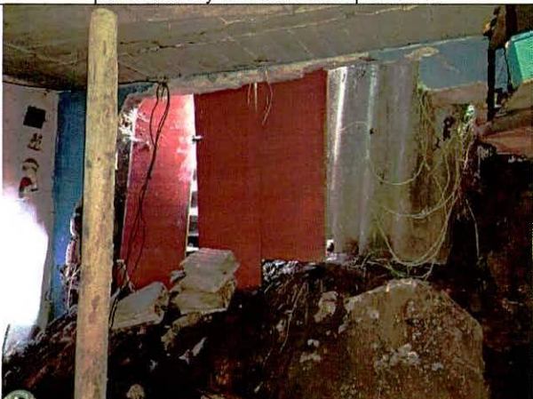
Fotografía 6. Colapso total del muro perimetral costado sur de la habitación ubicada al suroriente del predio P2.
