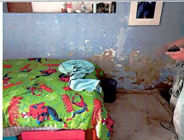
Fotografía 4. Problemas de humedad en parte inferior de muro perimetral costado sur, habitación 1 primer nivel. Predio P1.
