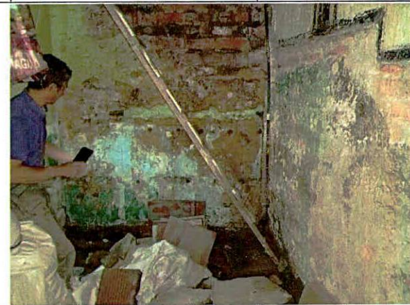
Fotografía 6. Problemas de humedad en muro perimetral occidental y costado sur del predio P1.
