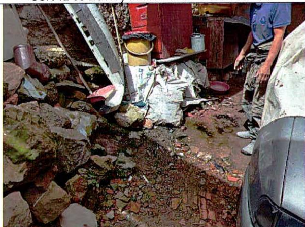
Fotografía 3. Filtraciones de agua y problemas de humedad en zona de parqueadero, predio P1.
