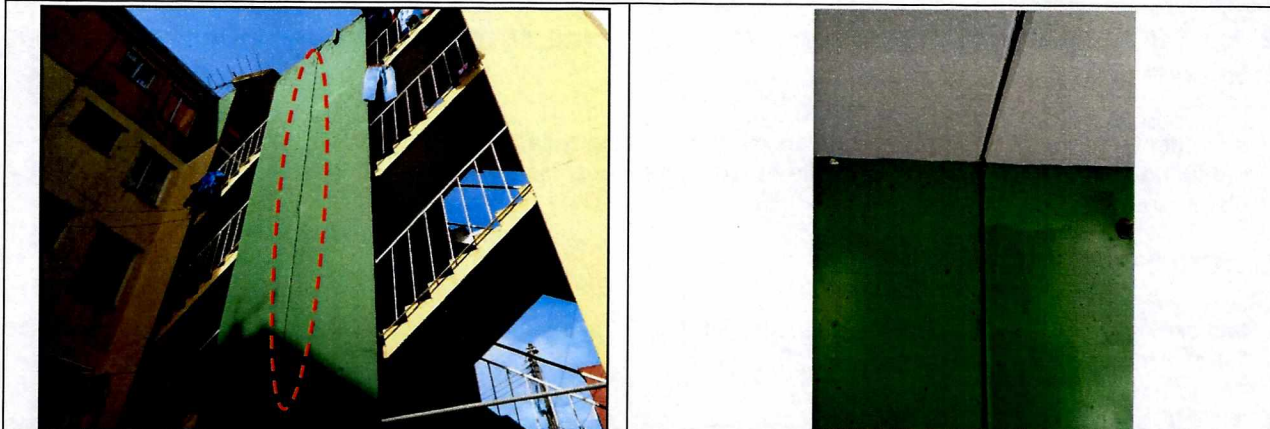
Fotos 3 y 4. Vista de la separación de las placas de concreto que conforman el punto fijo de las escaleras que unen los dos bloques..
