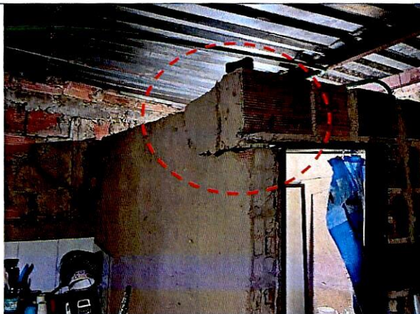
Fotografía 13. Grieta en el apoyo del dintel de la puerta del baño de V3
