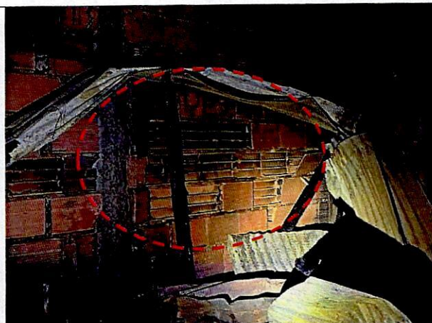
Fotografía 8. Falla frágil en mampuestos del muro de cerramiento del costado sur de V1
