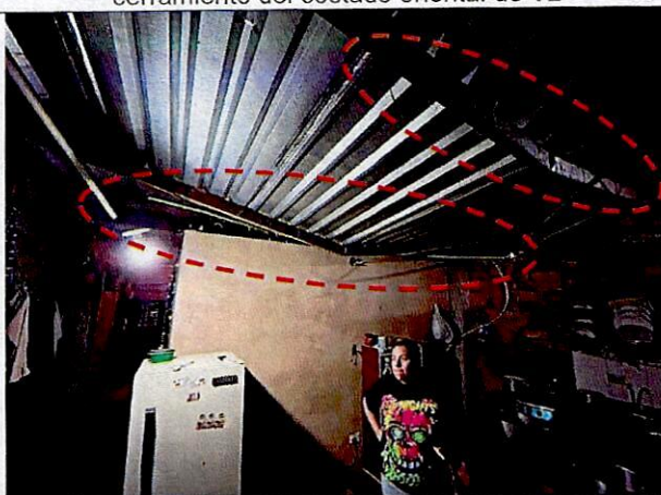
Fotografía 12. Deformación excesiva en las correas de la cubierta de la cocina de V3
