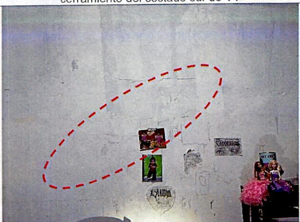
Fotografía 11. Grietas en muro de cerramiento del costado suroriental de V2
