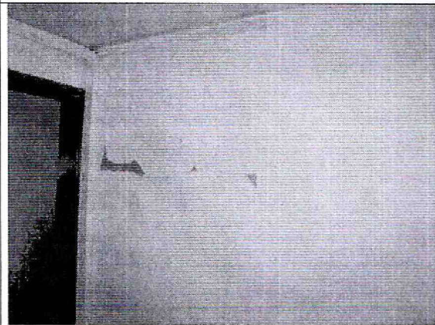
Foto 17. Grieta en muro de tercer nivel costado occidental.
