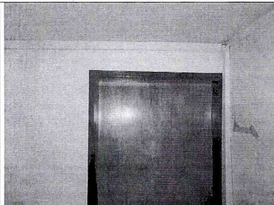
Foto 21. Marco de la puerta con deformaciones.
