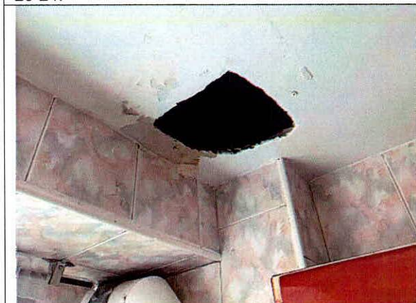
Fotografía 3. Ventana de inspección realizada sobre el cielo raso, donde se presenta la gotera.
