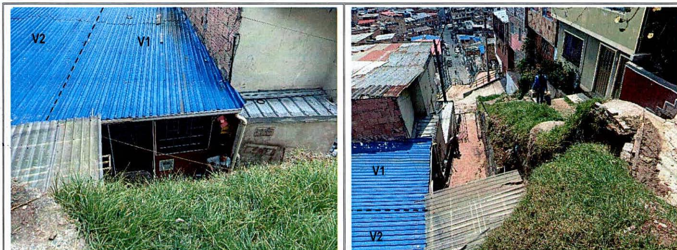
Fotos 5 y 6. Vista de las viviendas localizadas hacia la parte baja del talud, en el sector afectado y del ingreso a las mismas.
