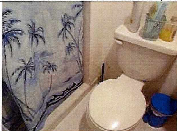
Foto 5. Humedades en muros divisorios de baño del Apto. 144.
