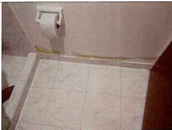
Foto 3. Humedades en muros divisorios de baño. Apto. 142.
