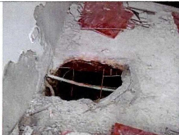
Foto 4. Perforación de placa de contrapiso en Apto. 142.
