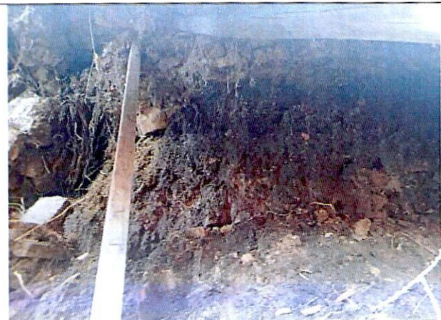
Fotografía 5. Vista del talud de corte localizado al costado oriental donde se han generado desprendimientos en el sector del predio P2.
