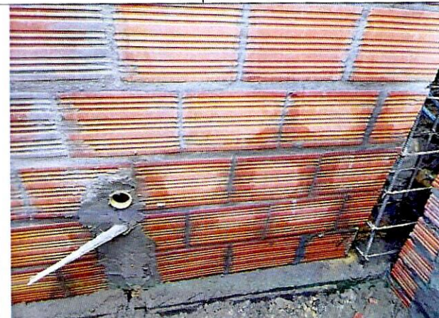
Fotografía 7. Humedad y abombamiento en el muro perimetral de la obra llevada a cabo en el predio P2.
