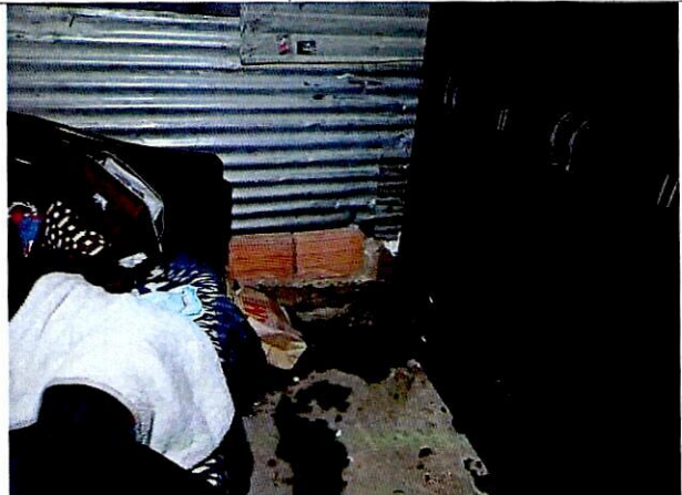
Fotografía 8. Humedad evidenciada hacia el costado oriental de la vivienda emplazada en el predio P1.
