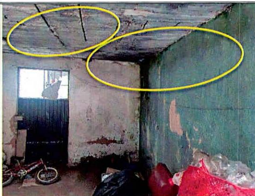
Foto 4. Vista general humedades en muros perimetrales, cubierta en concreto y exposición de refuerzo.
