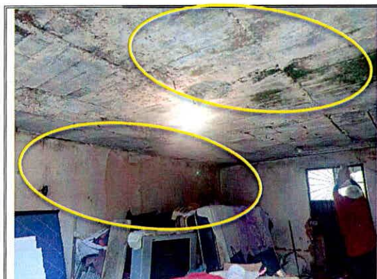
Foto 5. Vista general humedades en muros perimetrales y cubierta en concreto
