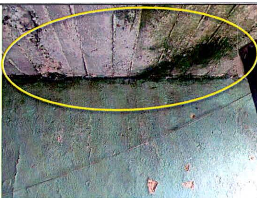
Foto 6. humedades en muros perimetrales y cubierta en concreto
