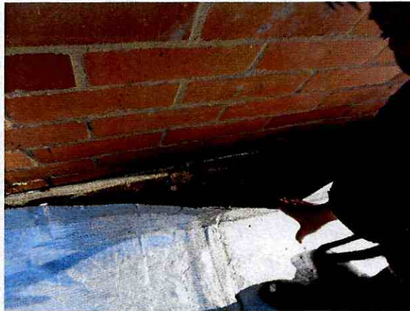
Fotografía 11. Desprendimiento del manto impermeabilizante que permite la filtración de agua.
