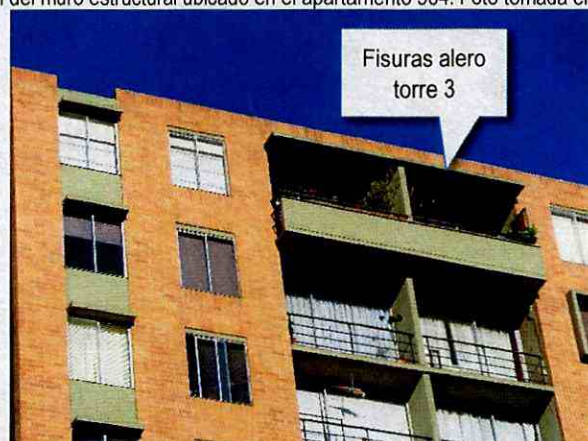
Fotografía 13. Fisuras que se presentan en el alero superior ubicado en la torre 3.
