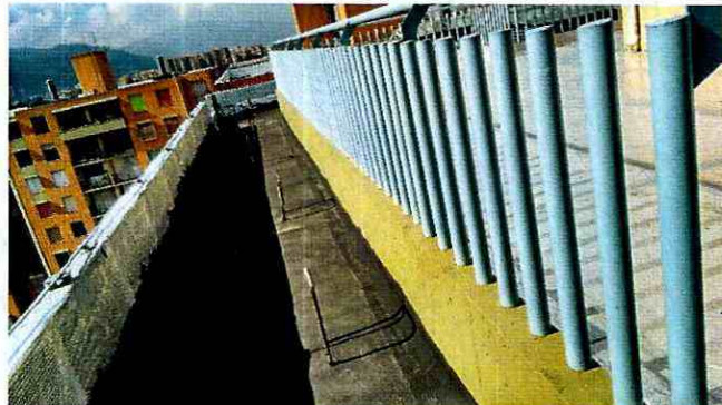
Fotografía 8. Placa de 30 cm aproximadamente que se construyó en la azotea de la torre 7 que genera una sobrecarga en la placa de terraza.
