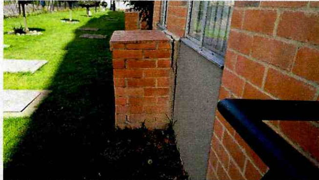
Fotografía 4. Desprendimiento de los muros de las cajas ubicadas en el costado occidental del predio.
