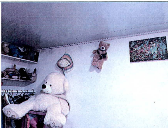
Fotografía 6. Vista de las humedades y filtraciones en la vivienda de P1
