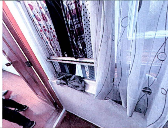
Fotografía 4. Vista de las humedades y filtraciones en la vivienda de P1
