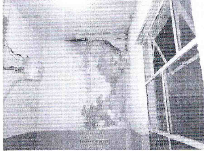
Foto 14. Deterioro alto de acabados de muros.
