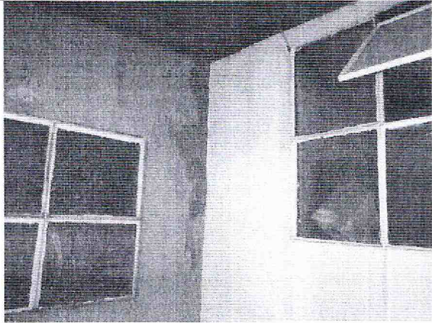
Foto 13. Deterioro por humedad en muros de tercer piso.
