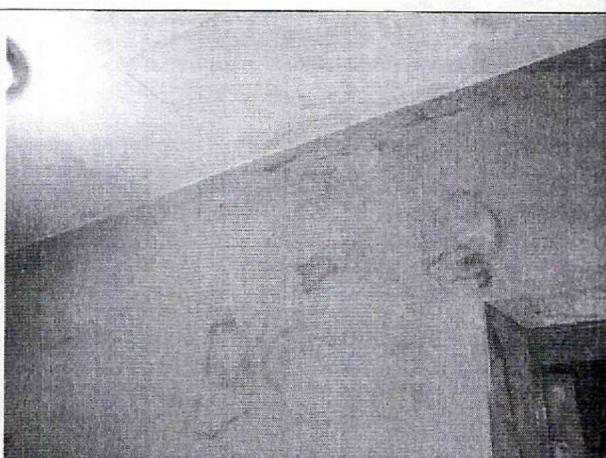
Foto 12. Deterioro de los acabados de muros.
