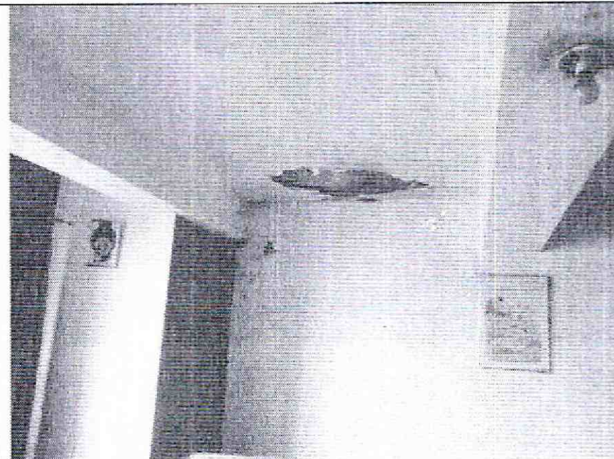
Foto 26. Daño del acabado del cielo raso por humedad.
