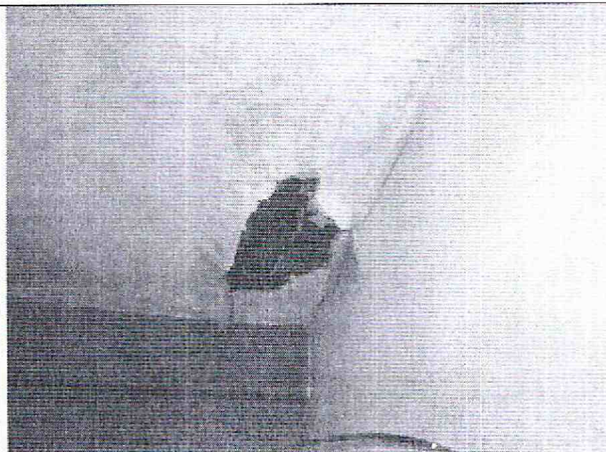
Foto 28. Daño de los acabados del cielo raso.
