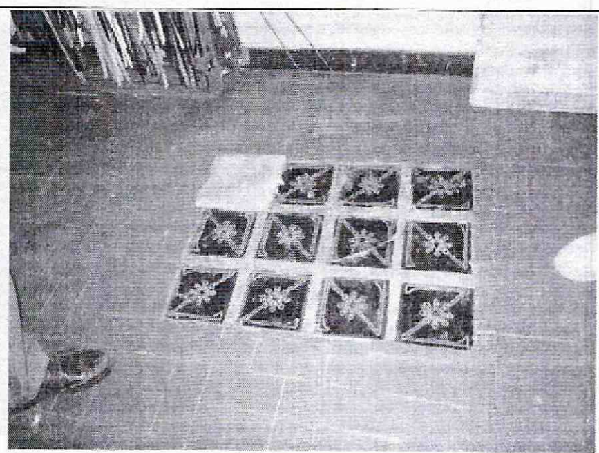
Foto 20. Daños en bloques de vidrio del entrepiso.
