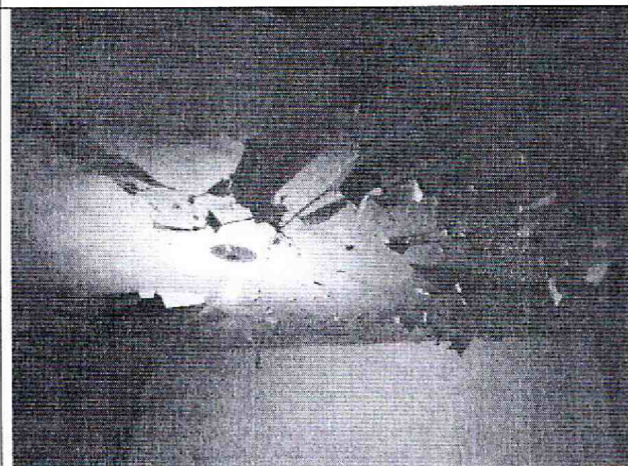
Foto 27. Alto deterioro del cielo raso.
