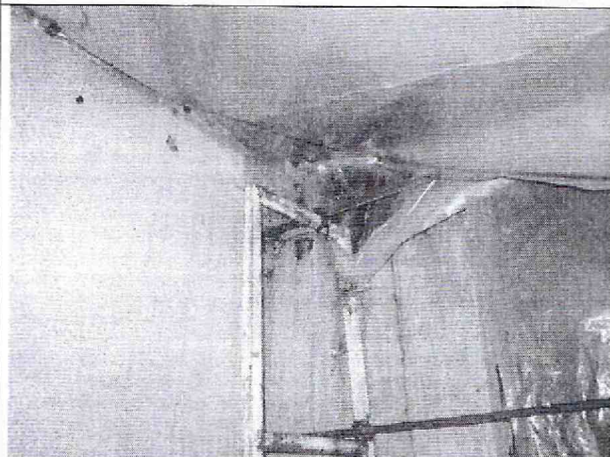
Foto 9. Marcas de escurrimiento de agua sobre muro.
