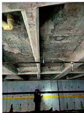
Fotografía 13. Deficiencias constructivas (cambio se sección) placa de entepiso a nivel de sótanos en el predio evaluado.
