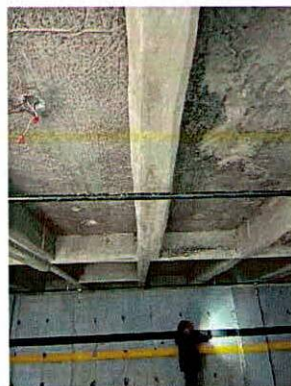
Fotografía 14. Deficiencias constructivas (cambio se sección) placa de entepiso a nivel de sótanos en el predio evaluado.
