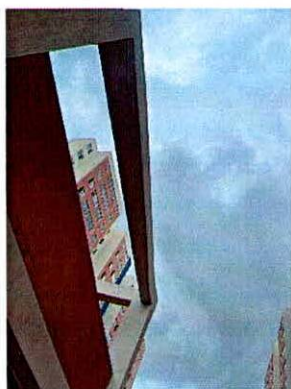
Fotografía 12. Deficiencias constructivas (cambio se sección) en viga de estructura de portería en el predio evaluado.
