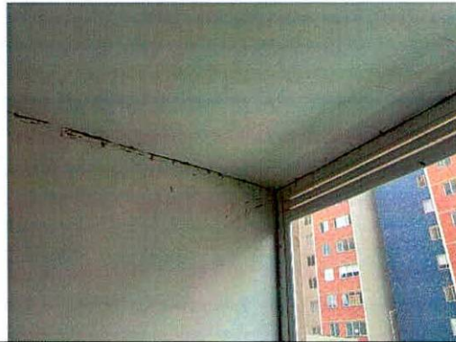
Fotografía 27. Desniveles de la placa de entrepiso apartamento 103 torre 3.
