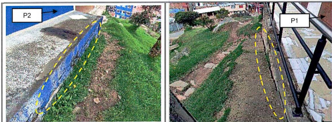
Foto 19 y 20. Vista general daños en muros de confinamiento andén frente a Predio P2 y grietas en andén Predio P1
