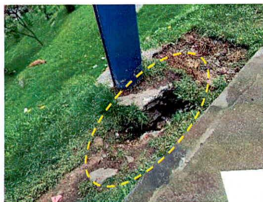
Foto 18. Vista general leve socavación en la zona donde se localiza el poste con leve pérdida de verticalidad.
