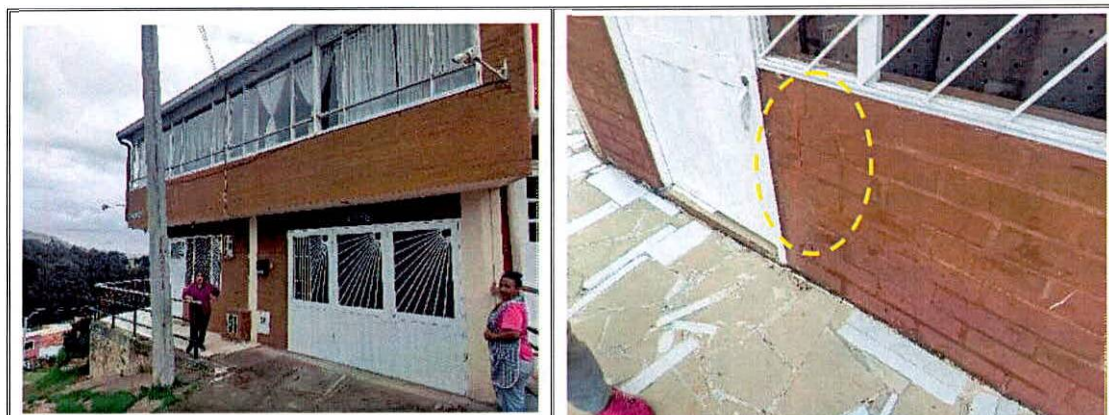
Foto 5 y 6. Vista general predio P1 y daños identificados en muro de fachada
