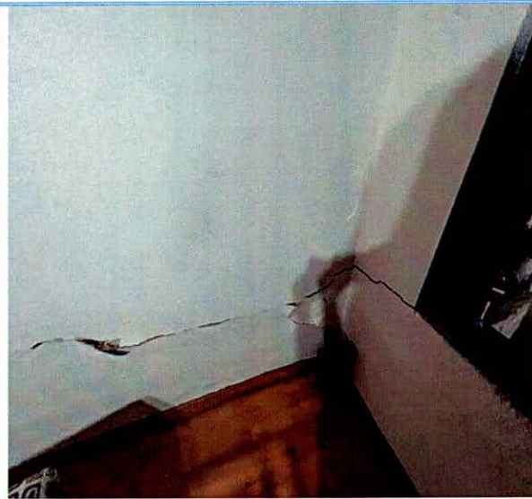
Fotografía 2. Grieta sobre muro perimetral habitación del primer nivel de la vivienda ubicada en la Cra 63 # 67 A -55.
