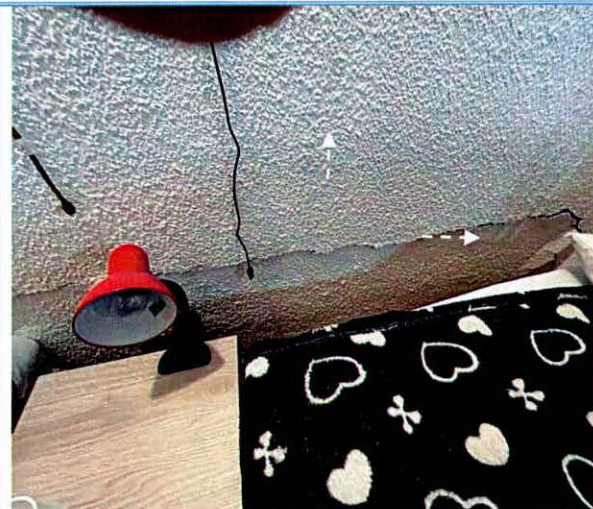
Fotografía 4. Grieta sobre muro perimetral segunda habitación de la vivienda ubicada en la Cra 63 # 67 A -55.
