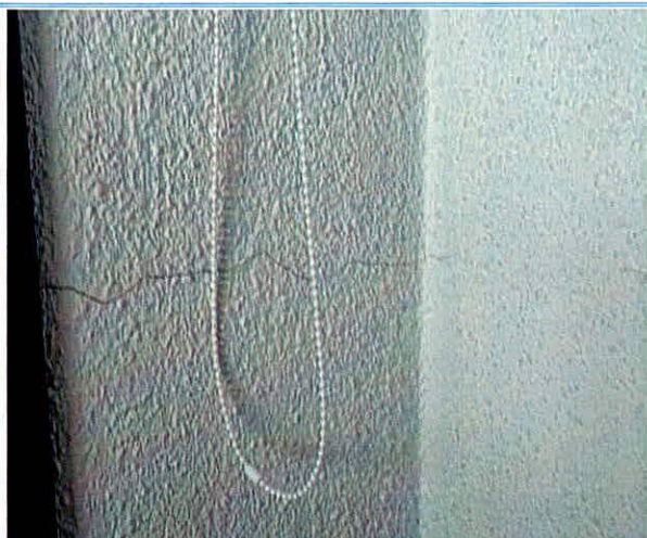
Fotografía 5. Fisura en habitación del segundo nivel de la vivienda ubicada en la Cra 63 # 67 A -55.
