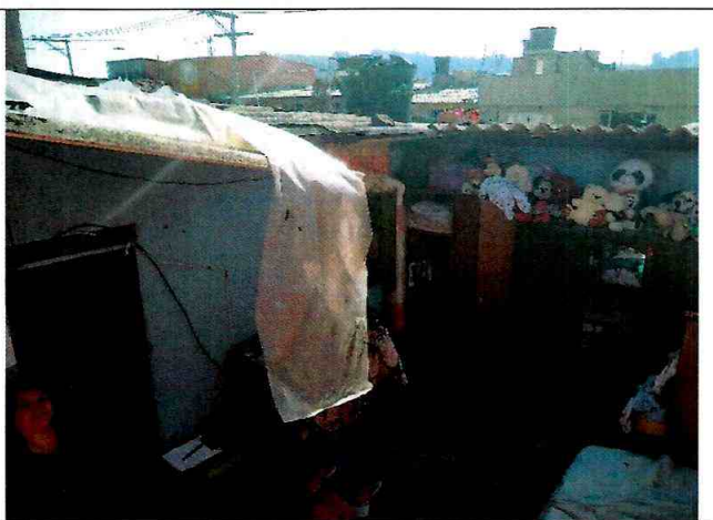
Foto 2. Colapso de cubierta en habitación del tercer nivel.
