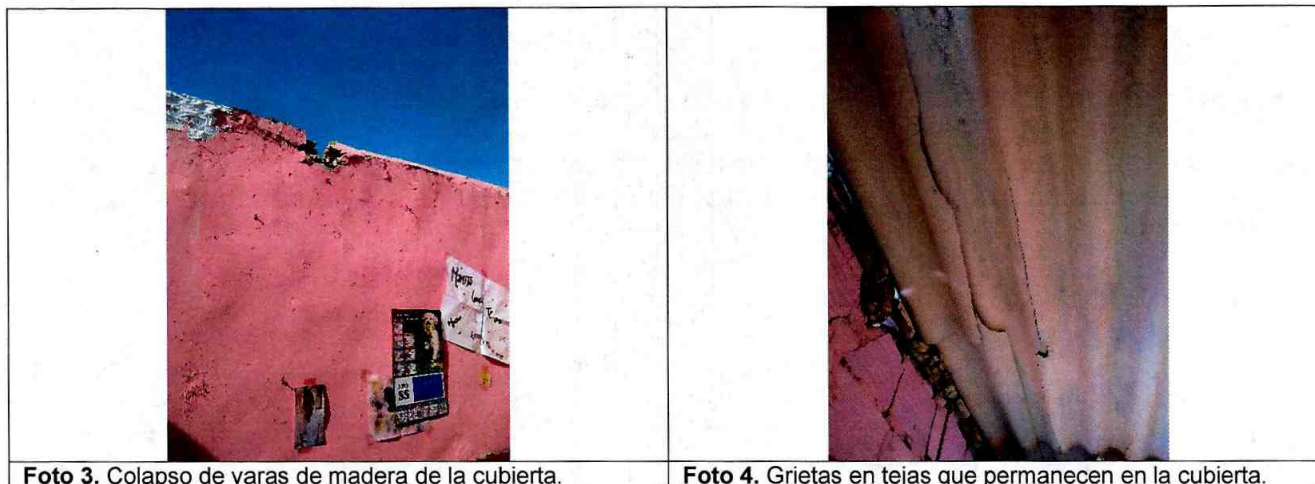
Foto 3. Colapso de varas de madera de la cubierta.
