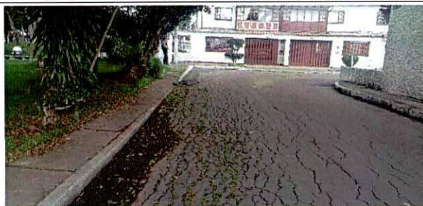
Fotografía 7. Vista general de grietas y hundimientos en la KR 68C, frente a la vivienda evaluada.
