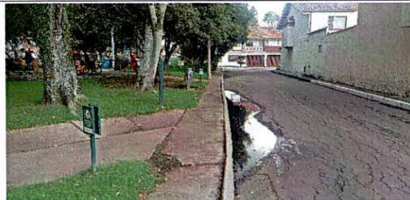
Fotografía 8. Vista general de grietas, hundimientos y empozamiento de agua en la KR 68C, frente a la vivienda evaluada.
