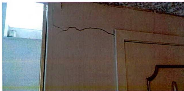
Fotografía 6. Vista general de grietas en muros divisorios de la vivienda evaluada.
