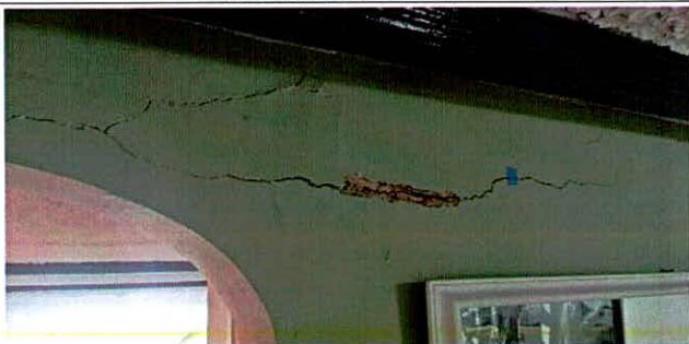
Fotografía 5. Vista general de grietas en muros divisorios de la vivienda evaluada.
