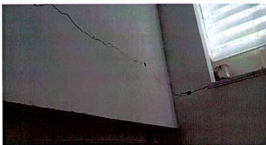
Fotografía 3. Vista general de grietas en muros divisorios de la vivienda evaluada
