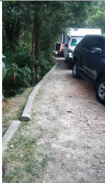
Fotografía 4. Falta de canalización de aguas superficiales en la corona del talud sobre margen derecha de la Quebrada La Vieja (21/01/2024)
