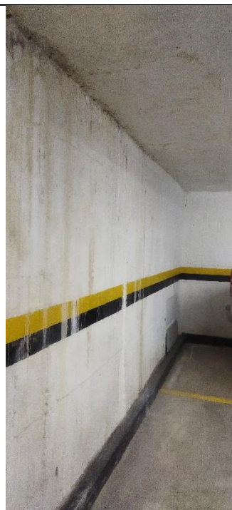
Fotografía 2. Humedad en muros y placas del Sótano del Predio (P1) Bosques de la Quebrada (21/01/2024)
