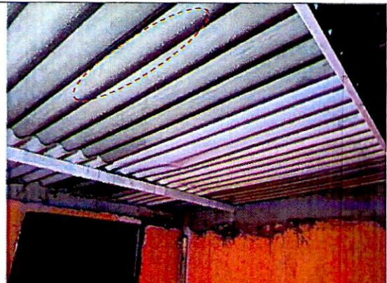
Fotografía 4. Las tejas de la habitación del último nivel presentan filtraciones.
