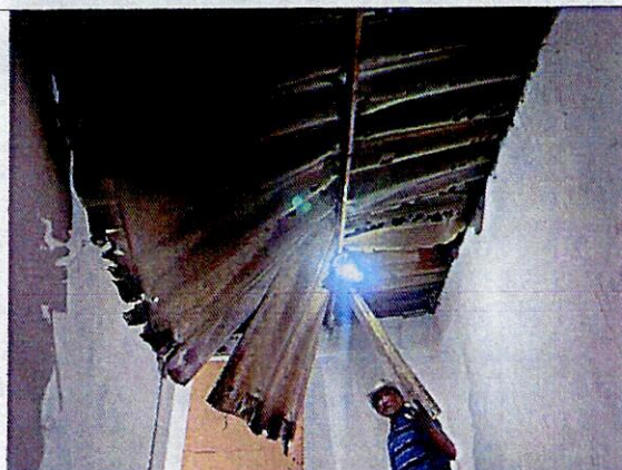
Fotografía 12. Colapso parcial de las tejas que conforman la cubierta en el sector de la terraza.
