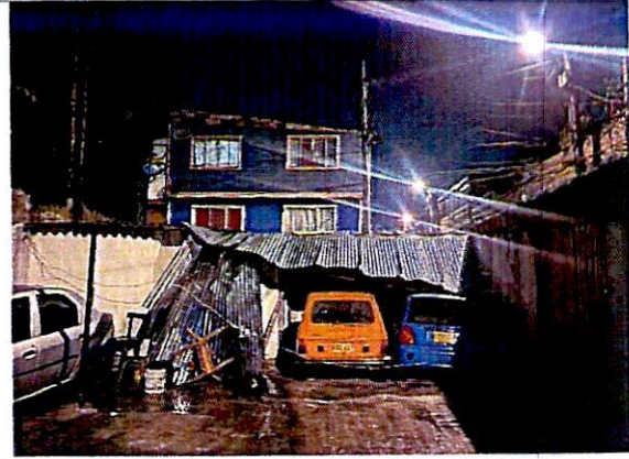
Fotografía 18. Parte frontal de P5, donde se localiza el parqueadero, presentó colapso parcial de cubierta, la cual, estaba conformada por tejas de zinc soportadas por estructura en madera.
