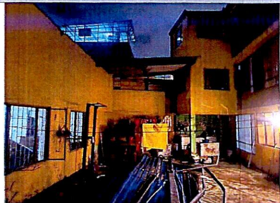
Fotografía 6. Colapso parcial de cubierta en zona de parqueadero. Al momento de la visita ya se habían recogido y acumulado los escombros y no se evidencian elementos adicionales expuestos.
