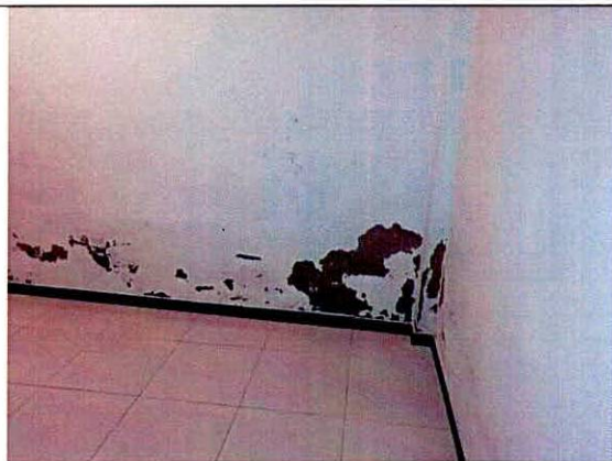
Fotografía 6. Filtraciones de agua y humedad en el costado posterior de la edificación que se emplaza en el predio P1.
