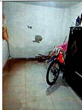
Fotografía 9. Filtraciones de agua, humedad y empozamiento de agua en el costado posterior de la edificación que se emplaza en el predio P2.
