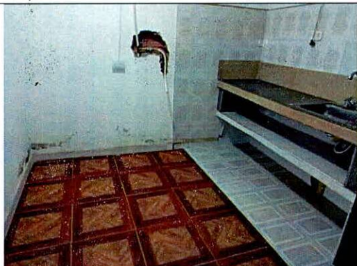
Fotografía 8. Filtraciones de agua, humedad y empozamiento de agua en el costado posterior de la edificación que se emplaza en el predio P1. del predio P1
