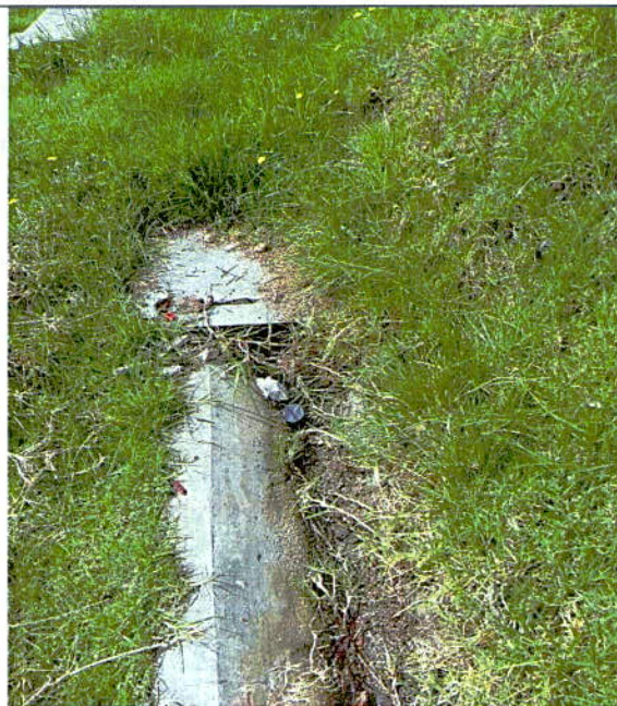
Fotografía 12 Cuneta localizada hacia la parte media de la ladera
