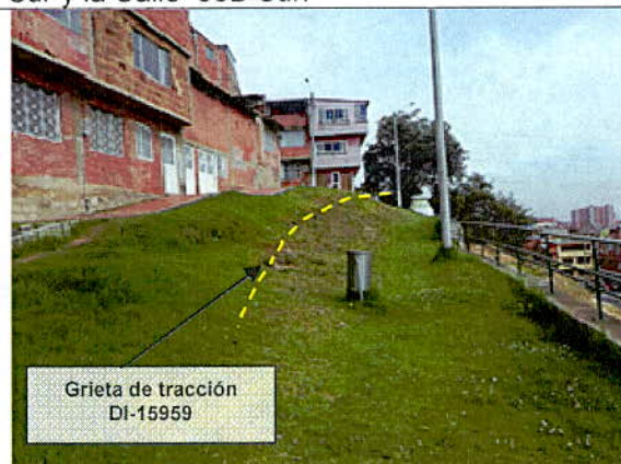
Fotografía 3. Desplazamiento del suelo contenido por la estructura de contención implementada
