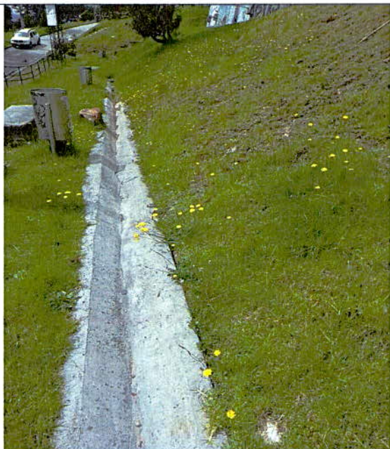
Fotografía 11. Cuneta localizada hacia la parte media de la ladera
