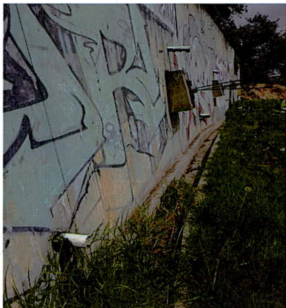
Fotografía 9. Estado de las cunetas de la parte baja del muro de contención.
