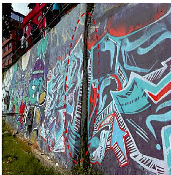
Fotografía 7. Desplazamiento de la base del muro de contención.
