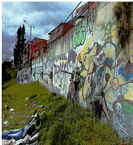
Fotografía 10. Estado de las cunetas implementadas en la parte baja del muro de contención.
