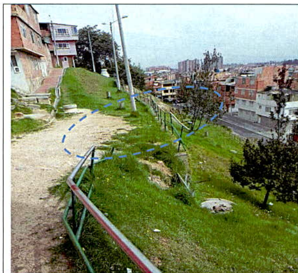
Fotografía 5. Desplazamiento de las barandas del muro de contención.
