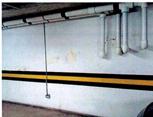
Fotografía 20. Manchas de humedad localizadas en muro perimetral a nivel de sótano (costado oriental) predio evaluado.
