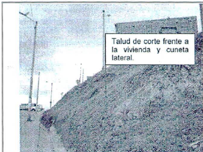
Foto 1. Vista del movimiento desde la parte baja (imagen tomada del DI-8115 correspondiente a la Foto No. 4)
