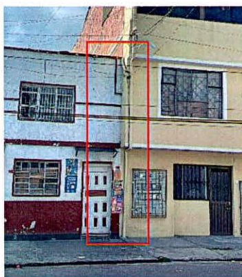
Fotografía 19. Ausencia de junta de sismica entre predio P2 y P1.
