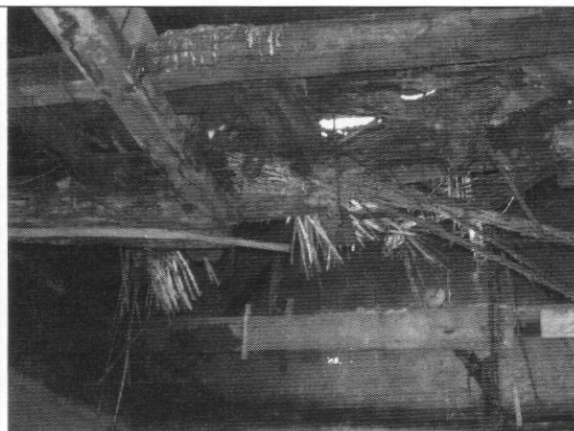
Foto 7. Elementos de cubierta en malas condiciones
