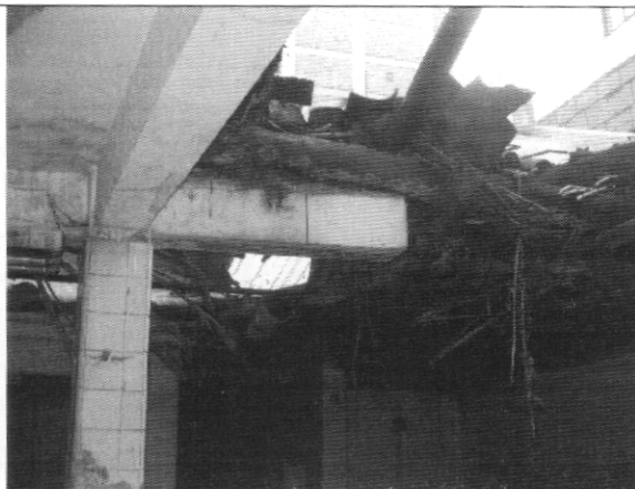
Foto 9. Colapso parcial de cubierta en zona posterior
