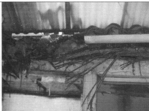
Foto 8. Cubierta en mal estado, zona posterior
