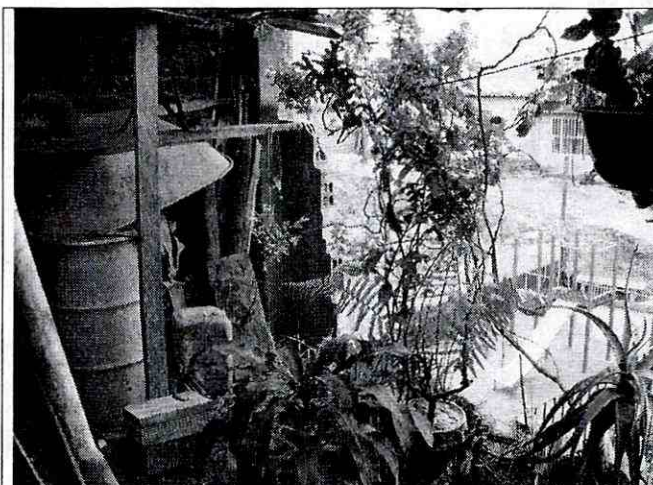
Foto 3. Detalle de la zona afectada por el colapso del muro de cerramiento del costado posterior.
