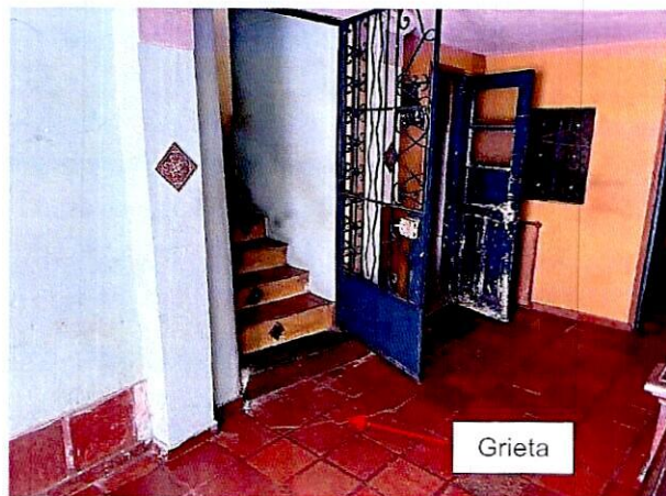
Posible grieta a tracción en la placa de contrapiso junto a la escalera del predio
