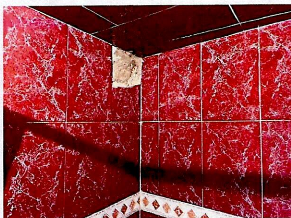
Desprendimiento de loseta de acabados en baño de la esquina suroccidental del predio
