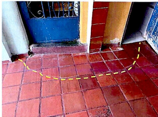
Posible grieta a tracción en la placa de contrapiso y hundimiento en la escalera del predio
