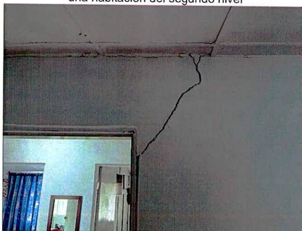
Grieta de aprox. 6mm de apertura en muro del acceso a una habitación del segundo nivel
