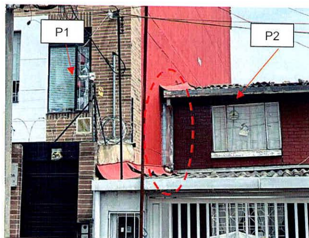
Fotografía 2. Junta de dilatación entre los predios P1 y P2
