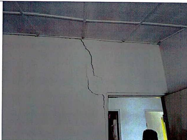
Grieta de aprox. 1cm de apertura en muro del acceso a una habitación del segundo nivel
