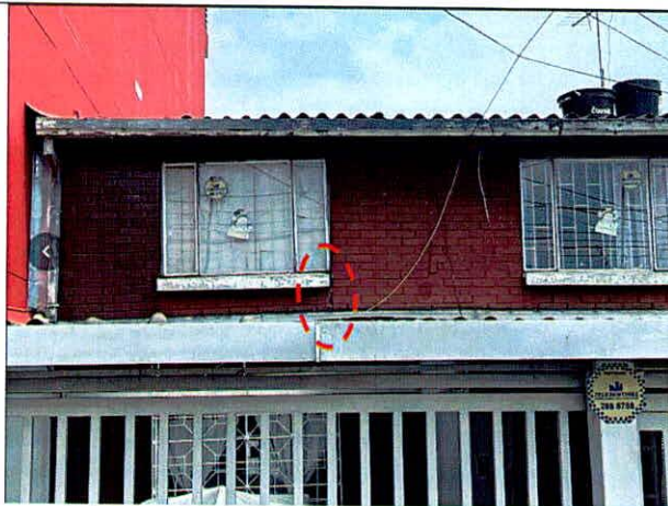
Grieta en fachada del segundo nivel del predio
