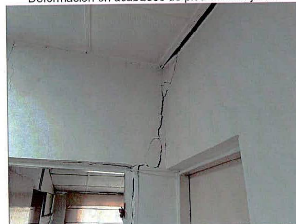
Grieta de aprox. 1cm de abertura en muro del acceso a una habitación del segundo nivel
