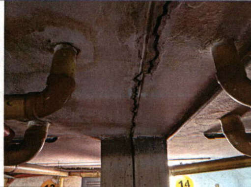
Fotografía No. 4. Vista de la grieta largo de la junta entre las estructuras que conforman los sótanos evaluados.
