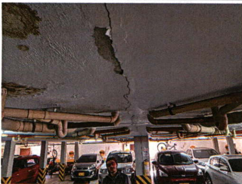
Fotografía No. 3. Vista de la grieta largo de la junta entre las estructuras que conforman los sótanos evaluados.
