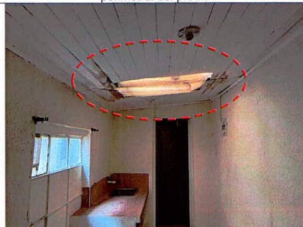
Fotografía 6. Humedad en cielo raso de la edificación de un nivel ubicada en el costado oriental del predio
