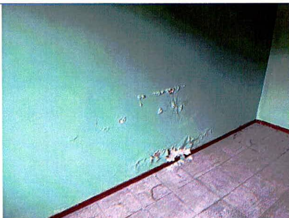
Fotografía 7. Humedad en la base de muros del segundo nivel del predio
