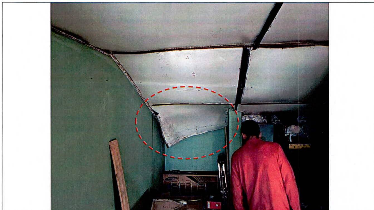
Fotografía 9. Filtración de agua desde la cubierta del segundo nivel del predio
