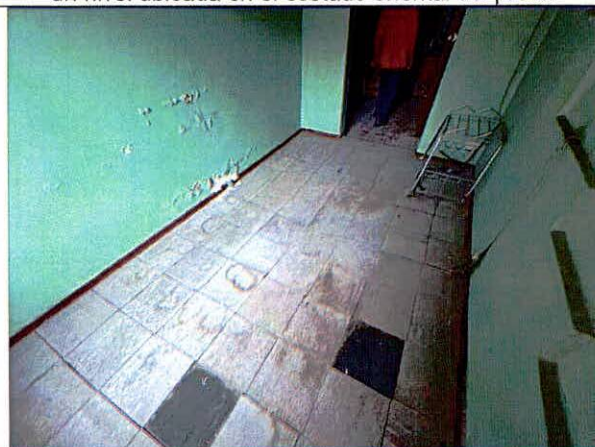
Fotografía 8. Humedad en entepiso de madera del segundo nivel del predio
