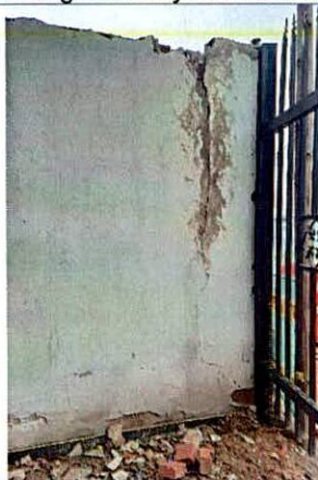
Fotografía 7. Fractura del muro y pérdida de verticalidad de cerramiento del costado norte.
