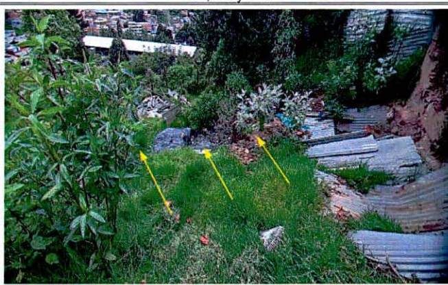
Fotografía 28. Demarcación del movimiento en masa en el terreno posterior a los predios P2, P3, P4 y P5.
