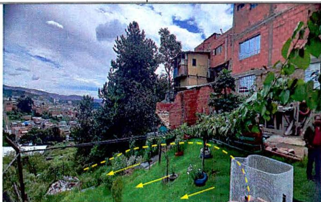
Fotografía 27. Demarcación del movimiento en masa en el terreno posterior a los predios P2, P3, P4 y P5.
