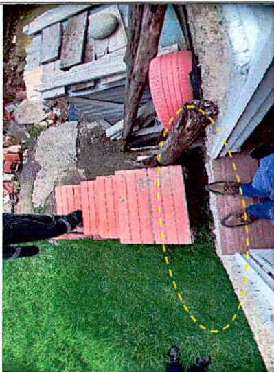
Fotografía 25. Separación entre piso de patio y muros posteriores del predio P4.
