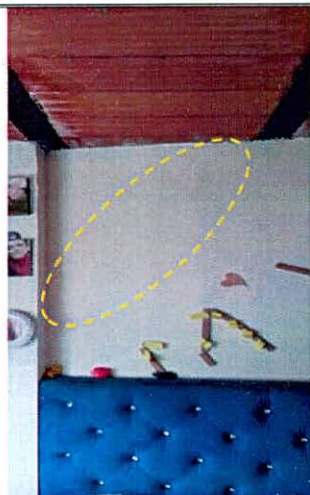
Fotografía 21. Daños en el predio P3.
