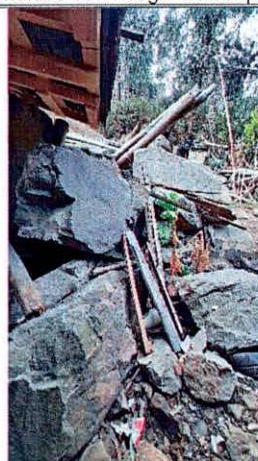
Fotografía 10. Caída y depósito de rocas sobre el costado norte de la vivienda P1-A
