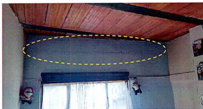
Fotografía 22. Daños en el predio P3.
