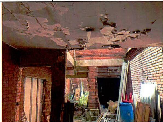
Fotografía 5. Humedades y desprendimientos de pañete y pintura.
